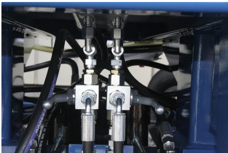
Obr. č. 5 Ventily v poloze pro ovládání podvozku
